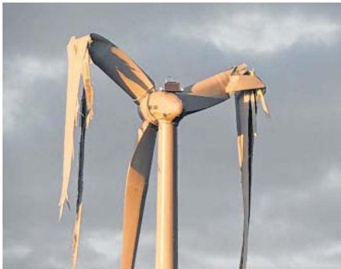
Weithin sichtbar: Die beschädigten Teile des Windrads müssen bis zum 6. April abgebaut werden.
