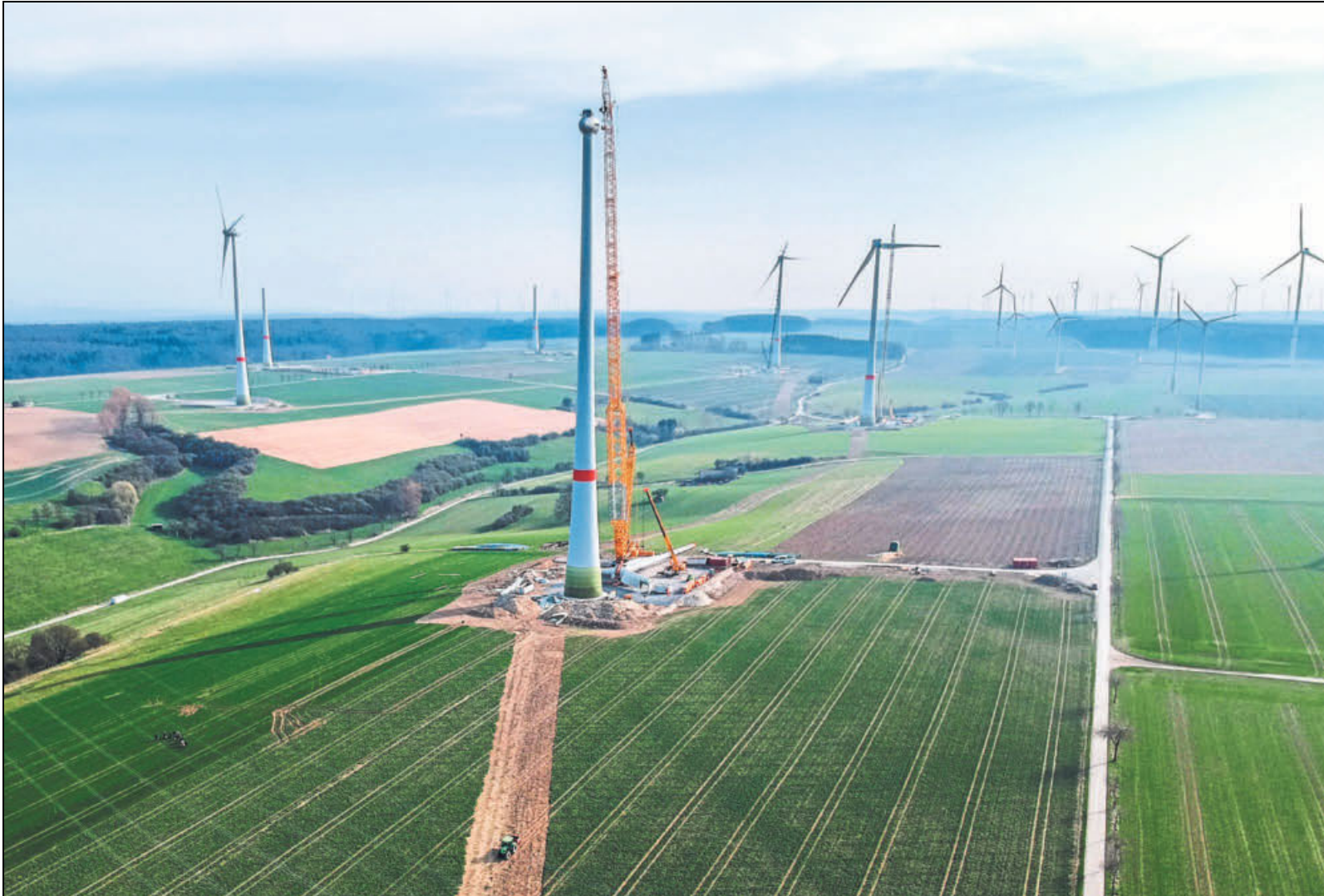
Der zerstörte Rotor wurde am 6. April abgebaut und vor den Betonturm gelegt.
